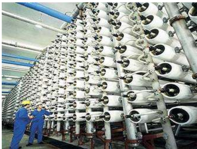
アシュケロンのプラントの内部
